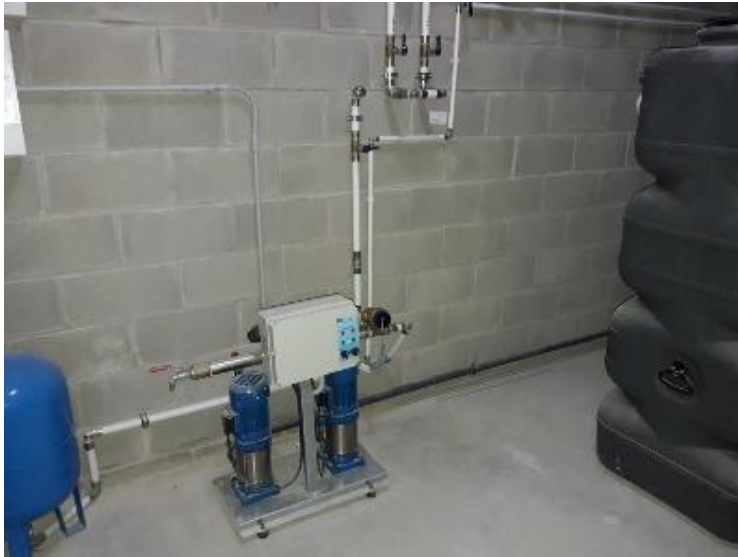
Imatge 3: 2 (1+1R) bombes d'impulsió d'AG a cisterna.
