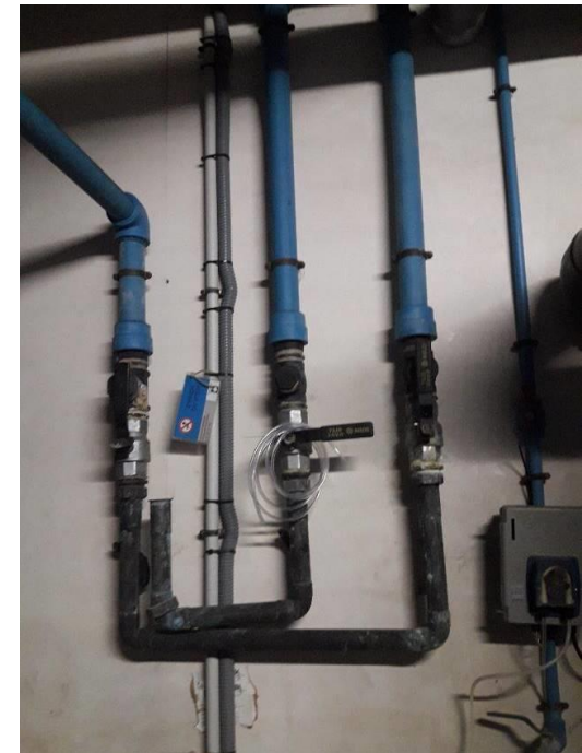
Imatge 10: By-pass aigua potable.
