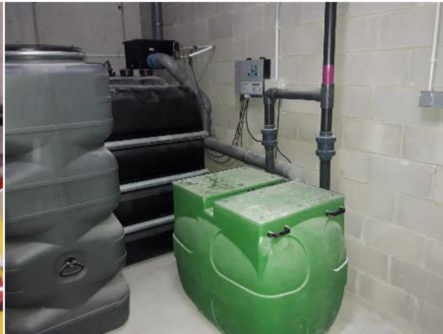
Imatge 2: Depuradora d'AG. Filtre d'entrada, dipòsit de membranes, dipòsit aigua tractada, sobreeixidor depuradora connectat a xarxa clavegueram.
