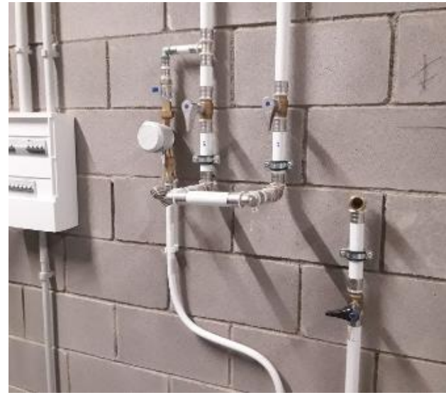
Imatge 4: By-pass aigua potable.
